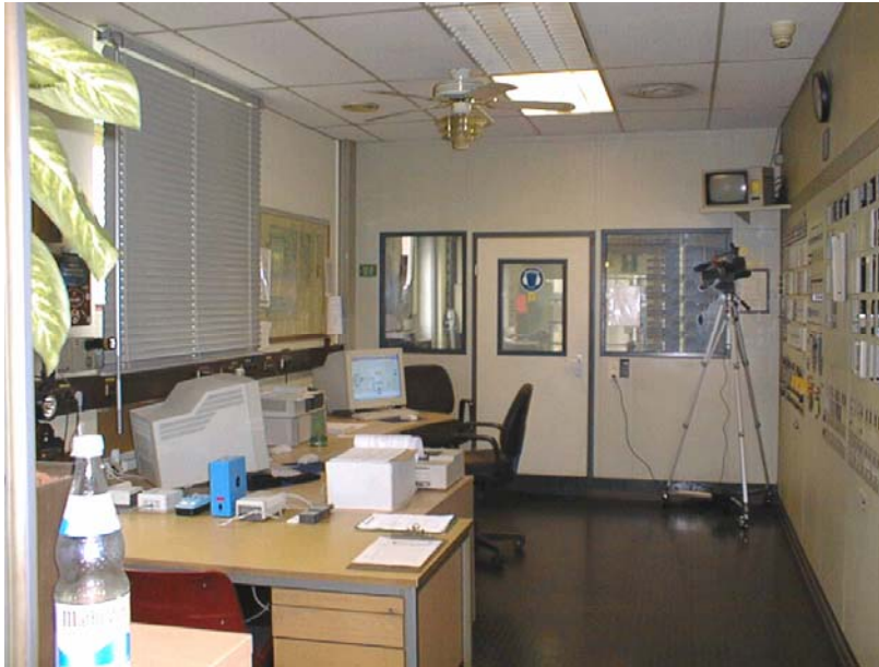
die alte Energie-Leitwarte (lokal, Kesselhaus)
